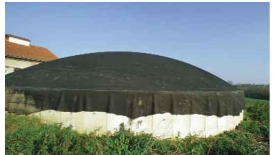
Gassammelbehälter der Biogasanlage Gut Sambach.
