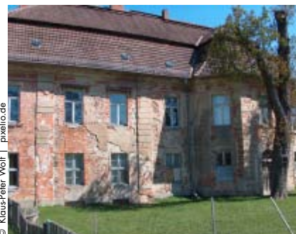
Zeitpunkt für notwendige Kleinstreparaturen verpasst
